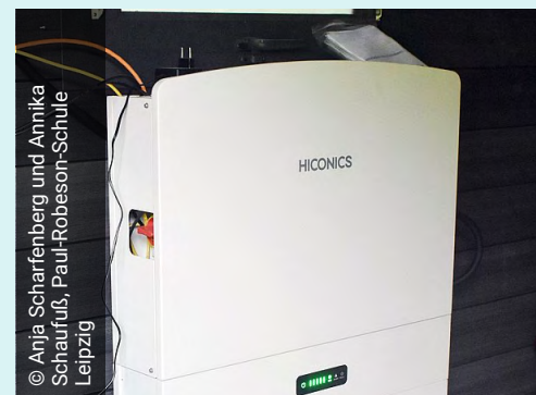
Der Batteriespeicher der Photovoltaikanlage macht die Zwischenspeicherung des erzeugten Solarstroms am Schulstandort sichtbar
